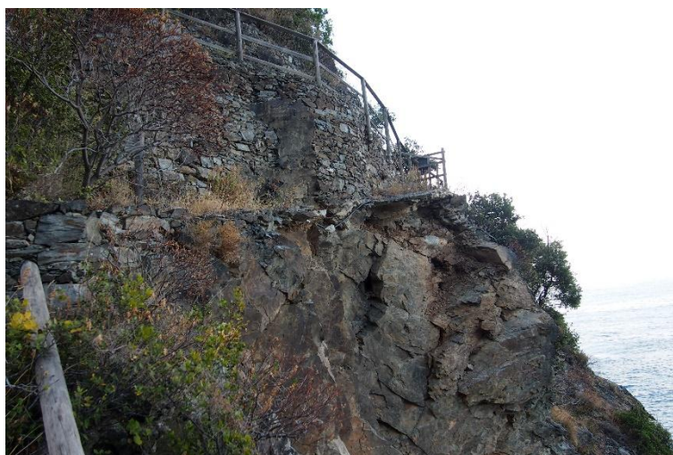
Figura 5.1: Esempio di rischio per la stabilità della sede pedonale associato a dissesti originati a valle della stessa – Settore A – Var. Bassa: collasso della variante di accesso all'area pic-nic in conseguenza del crollo dell'ammasso roccioso su cui poggiava
