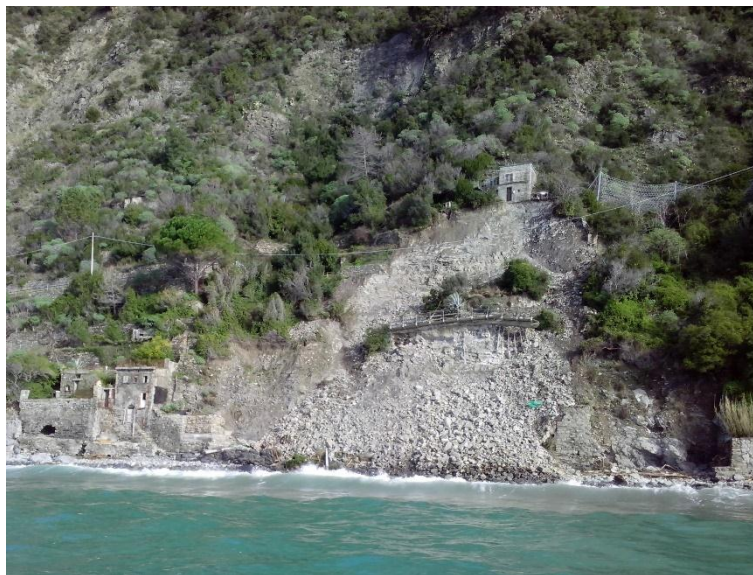
Figura 4.2: Immagine (01/2014) che evidenzia il cedimento della paratia di micropali realizzata lungo il sentiero per ricostruire la sede pedonale in corrispondenza del fenomeno franoso caratteristico del settore E (alla Figura 3.3b lo stato attuale del dissesto in parola).
