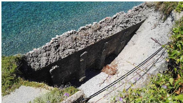
Figura 3.2: crateri creatosi a monte del muraglione ex-ferrovia nella parte centrale del settore F con conseguente crollo della sede pedonale
