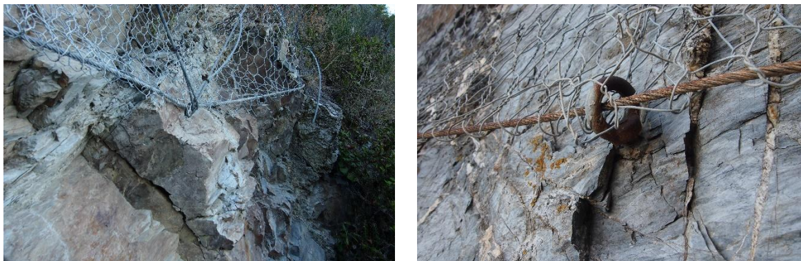
Figura 4.6: Reti di placcaggio nei settori A e B: morsettature carenti, ancoraggi inadeguati, inadeguata protezione contro la corrosione della componentistica.
