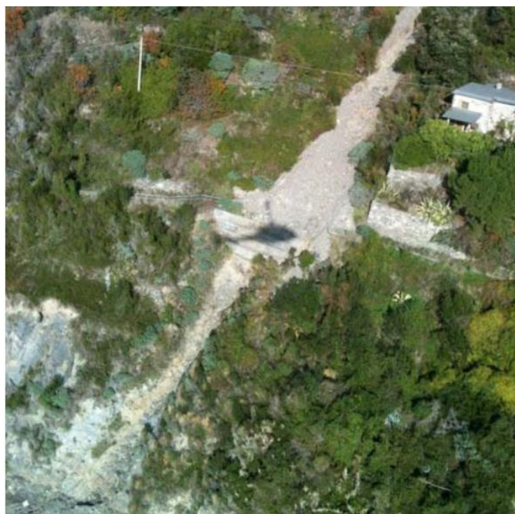
Figura 4.3: Danneggiamento alla sede pedonale in corrispondenza della Lama della Bansuola; il dissesto è prodotto dall'accumulo di detriti in movimento lungo l'asta torrentizia impossibilitati a raggiungere la base del versante per effetto dell'interruzione alla sezione di deflusso generata dalle file di gabbioni realizzati in alveo per il consolidamento del sentiero
