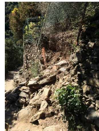
CROLLO LOCALIZZATO MURO A SECCO
